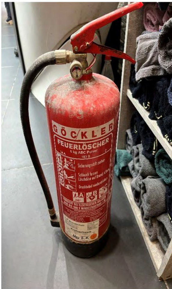
Foto: Nicht geprüfter Feuerlöscher in einem Friseurbetrieb
