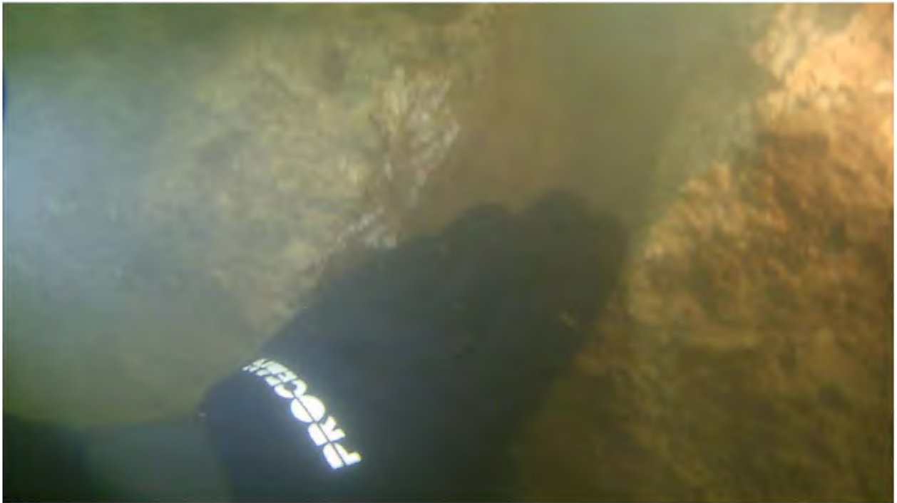
Foto: Unterwasseraufnahme eines handbreiten Spaltes im Pfeiler/Fundamentbereich aufgrund der Unterspülung des Fundaments (Quelle: strassen.nrw.de)
