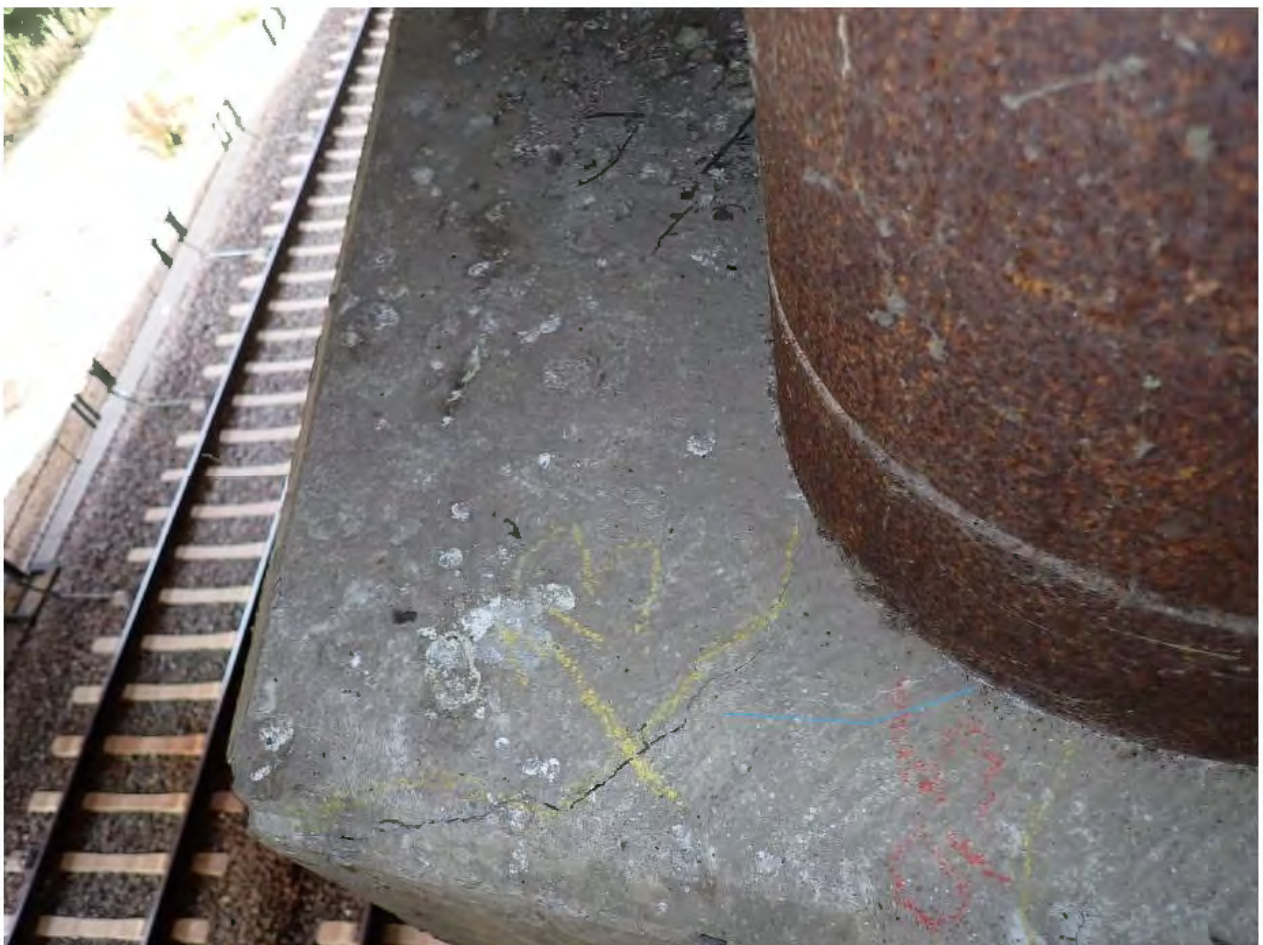
Abb. 1: Rissbildungen im Bereich eines Brückenpfeilers
